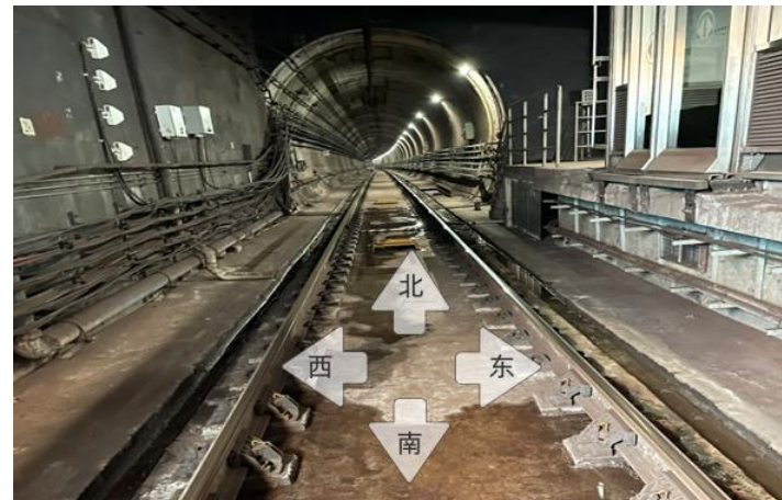
洞内结构变形、漏水
